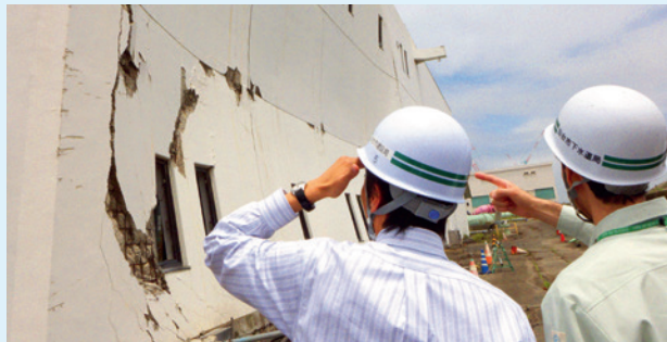
遭到2011年海啸破坏的污水处理厂。
